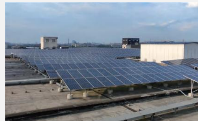
通利科技楼顶光伏
