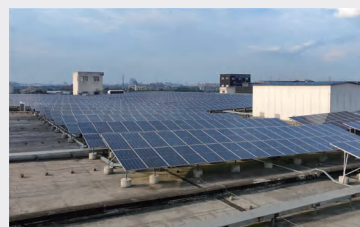
通利科技楼顶光伏
