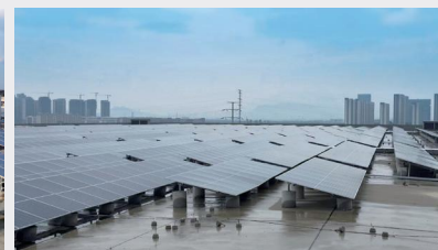
慧智新材楼顶光伏
